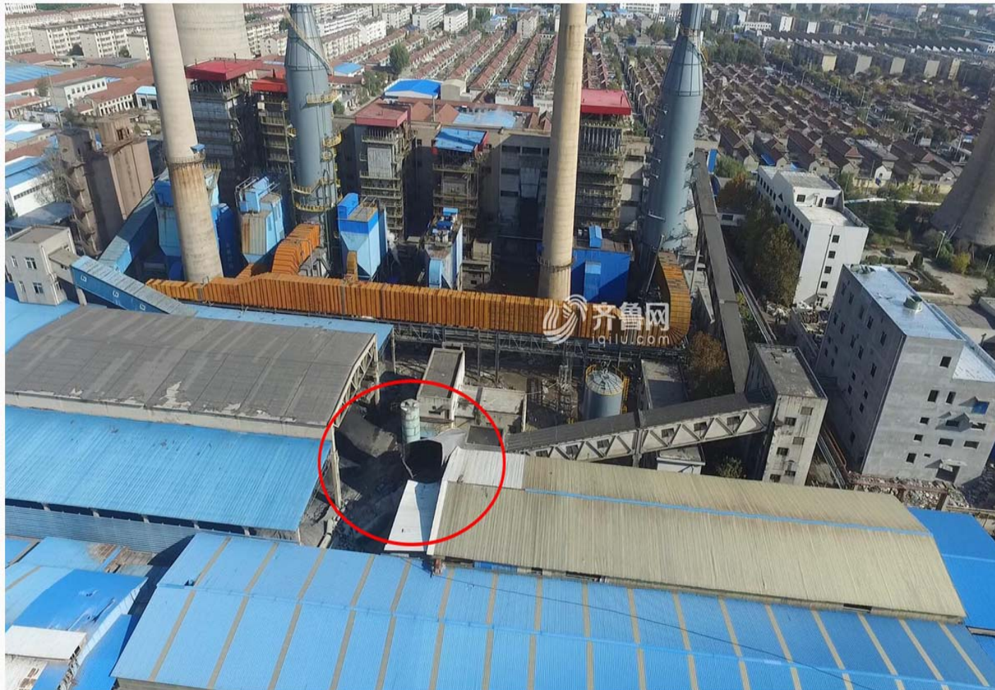
图为脱硫脱硝装置氨水罐
