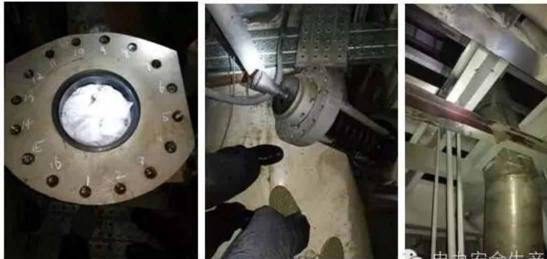
图1 炉左侧PCV阀宏观检查照片
